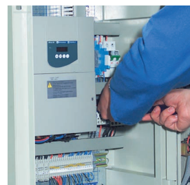
PANEL STEROWANIA Z PRZETWORNICĄ CZĘSTOTLIWOŚCI (FALOWNIKIEM)
